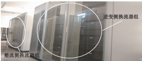
图 7 换流器组 Fig. 7 Converter group
