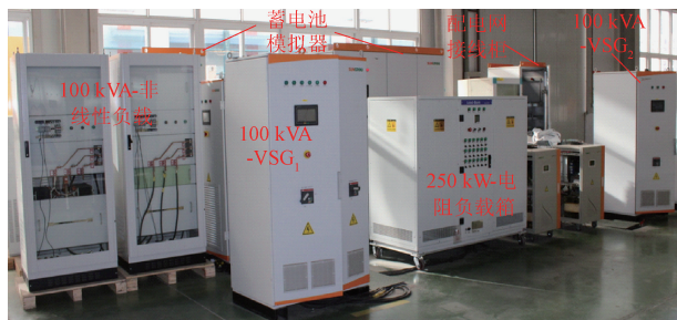
图8 储能微网系统硬件平台
