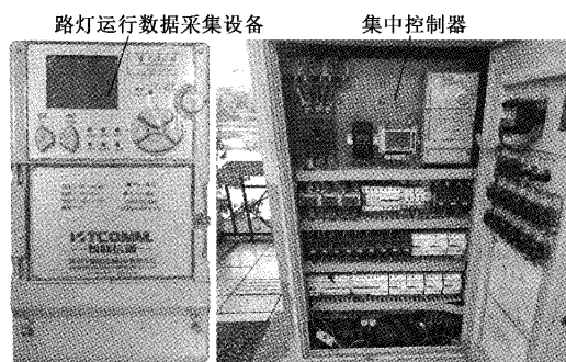
图 2 路灯运行数据采集设备与集中控制器
