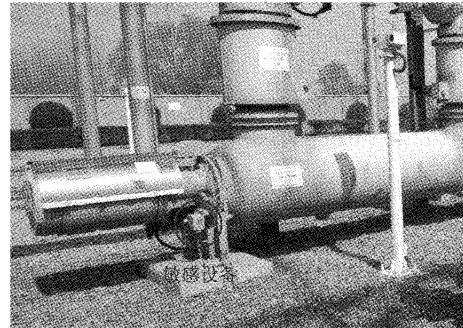
图 1 变电站内的敏感设备
