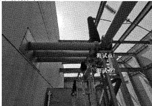
图 6 220 kV 的 GIS 设备
