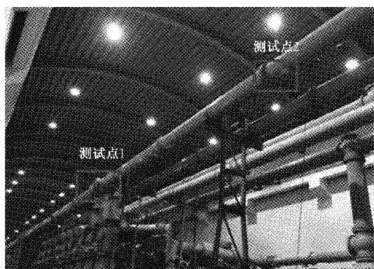
图12 500 kV的GIS设备
